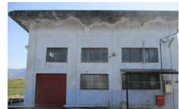
富士見排水機場ポンプ小屋
