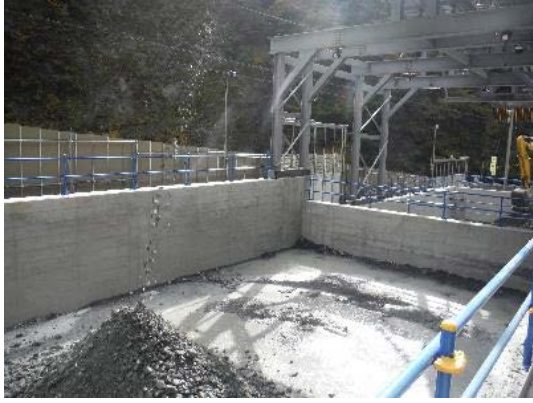
写真 6-5-13 土砂ピットにおける 掘削土砂管理 (底盤及び周囲のコンクリート打設) (早川非常口)
