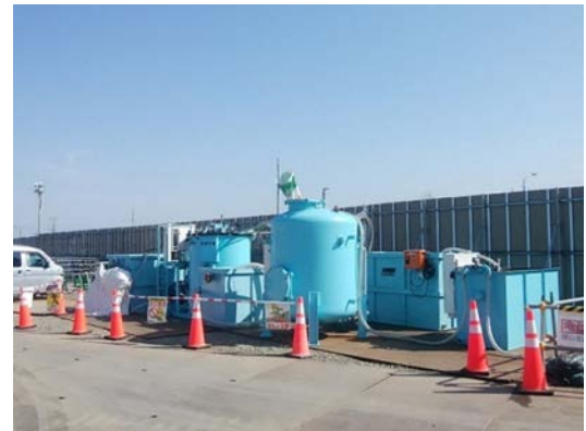
写真6-2-11 濁水処理設備
