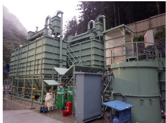
写真 6-5-10 濁水処理設備 (早川非常口)
