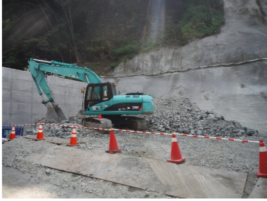
写真6-4-11(1) 土砂ピットにおける掘削土砂の管理（底盤及び周囲のコンクリート打設）
