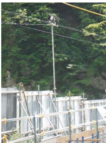
写真 6-5-17(1) LED 照明 (点灯前) (早川非常口)
