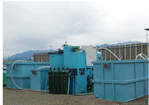
写真6-1-9 濁水処理設備
