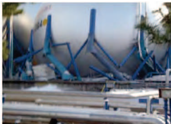
3月11日15時15分頃 水張り中の貯槽が座屈
