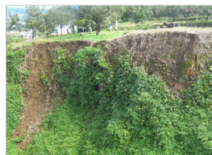
農地法面の崩落
