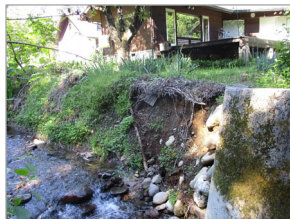
水路護岸の浸食
