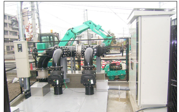
【排水ポンプ能力の増強】
