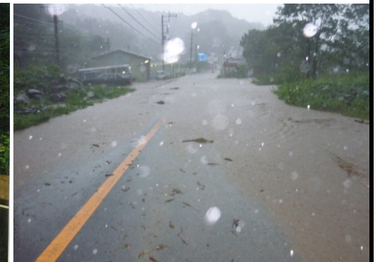
写真③ 平成23年9月21日 国道300号冠水状況
