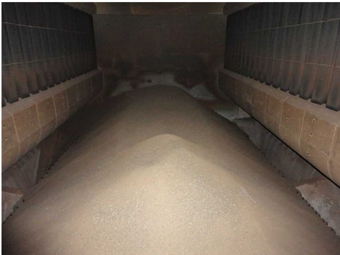
内部循環式流動砂床内部の写真
