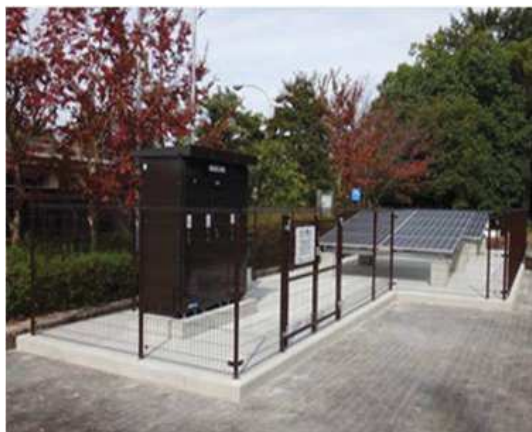
← 太陽光発電+リチウムイオン 蓄電池システム
