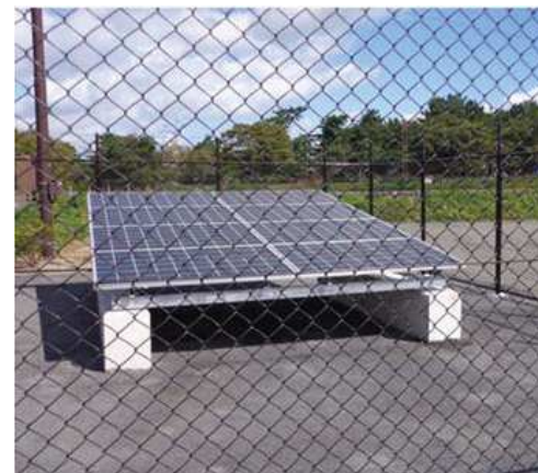
→ 非常用太陽光パネル
