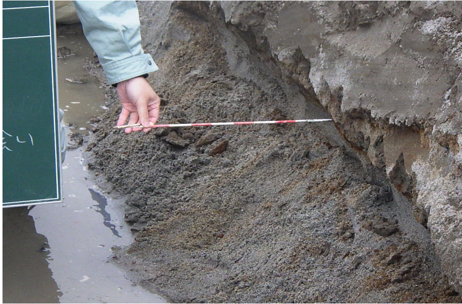
▲堰の施工箇所における地盤及び湧水の状況 (軟弱地盤かつ湧水の影響により掘削面が崩壊。当初計画したオープン掘削では施工困難な状況が確認された)
