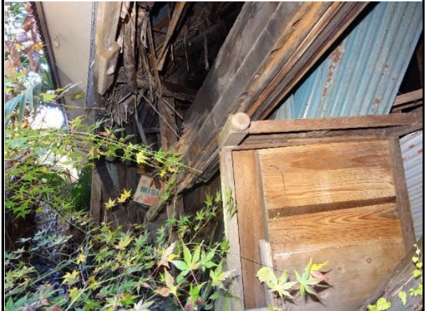
納戸（西側崩落部）
