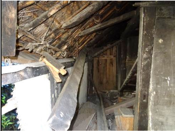
納戸（西側崩落部）
