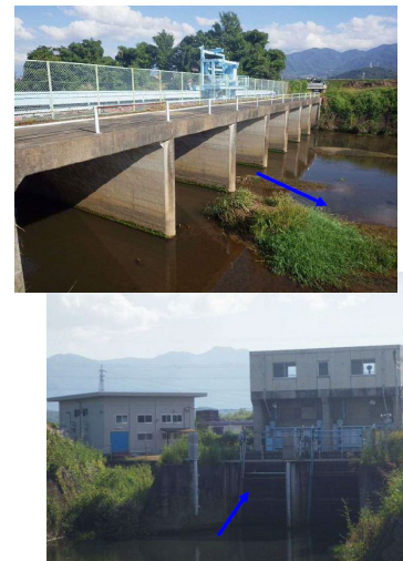
穏池排水機場
