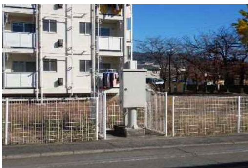
上町第二マンホールポンプ場
