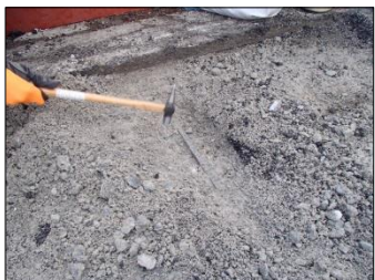
舗装下のコンクリートが劣化
