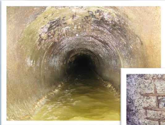
管路内の劣化状況
