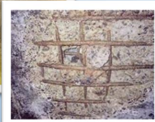
管路内の鉄筋露出
