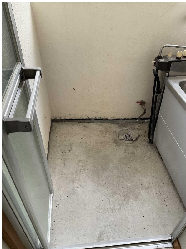
⑦ 建物1階 南側 風呂 床が陥没している
