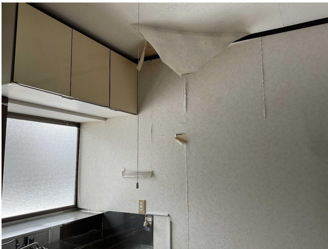
④ 建物1階 南側 台所 天井に壁紙の剥がれあり
