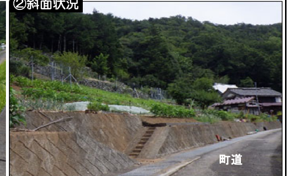
②斜面状況
