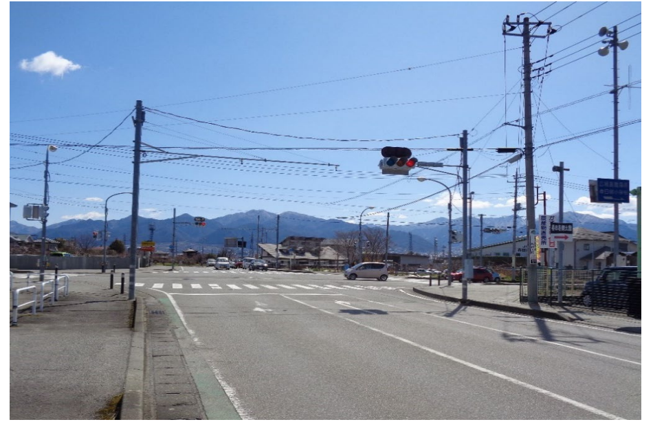
【写真①】 災害時の電柱の倒壊により緊急輸送道路の機能が発揮できない恐れ
