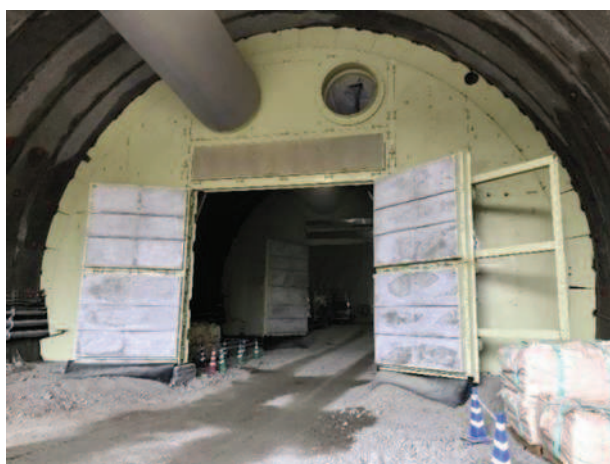
写真 7-5-1 二重構造にした本線トンネル坑口部防音扉（第四南巨摩トンネル品川方坑口部）
