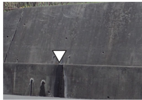
地下水の流出
