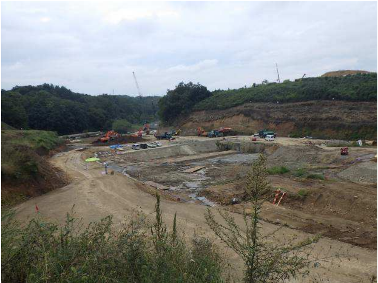
図 2-2-18(3) 最終処分場の工事実施状況（埋立地 下流側） 平成 28 年 9 月時点
