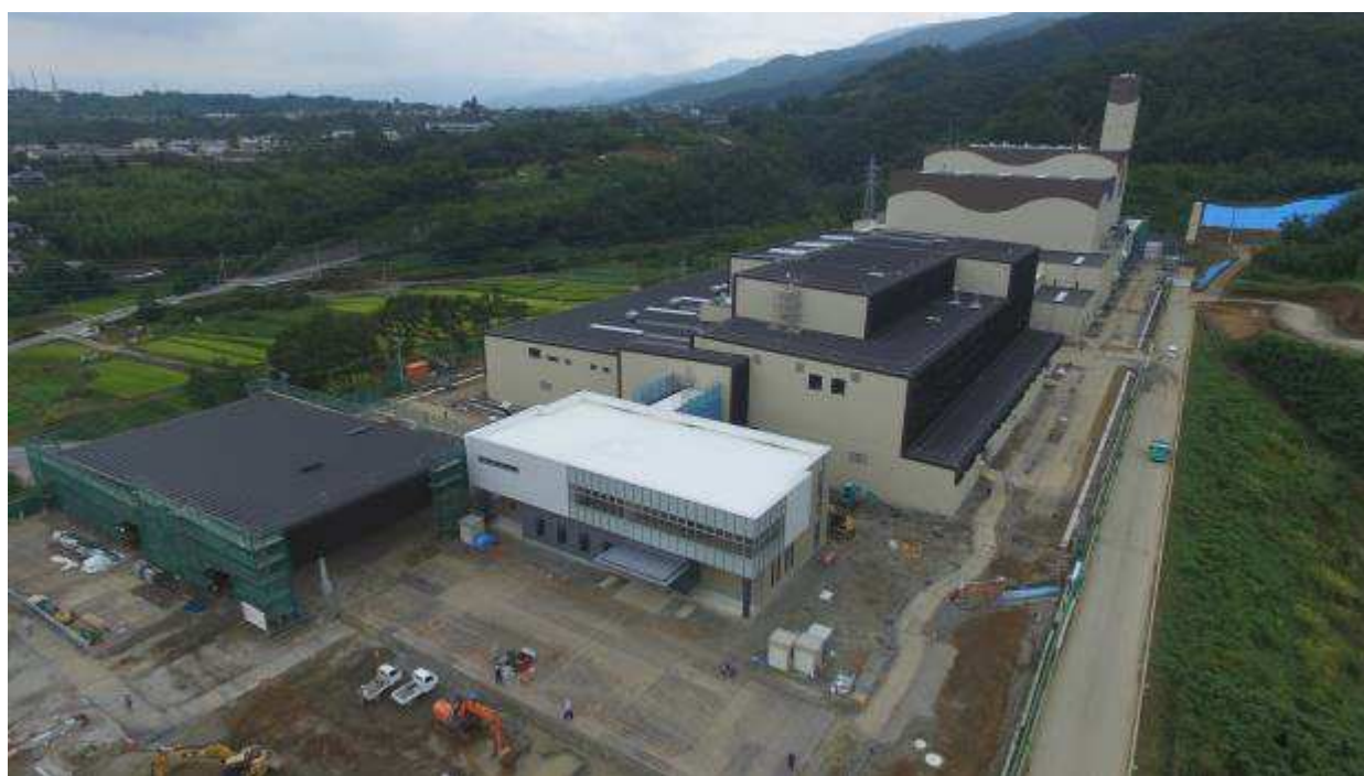
図 2-2-17(2) ごみ処理施設の工事实施状況（全体 西側視点） 平成 28 年 9 月時点
