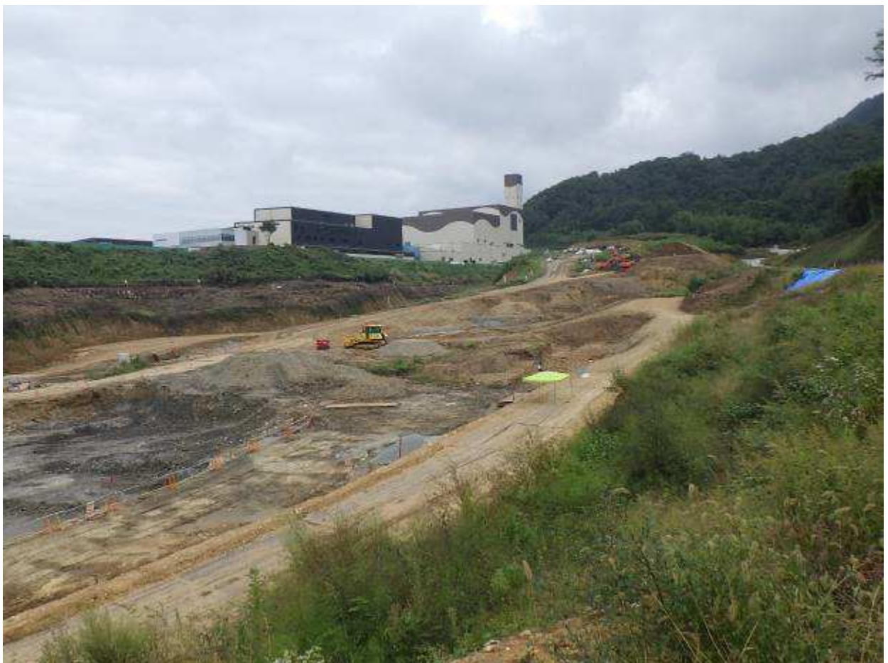
図 2-2-18(2) 最終処分場の工事实施状況（埋立地 上流側） 平成 28 年 9 月時点
