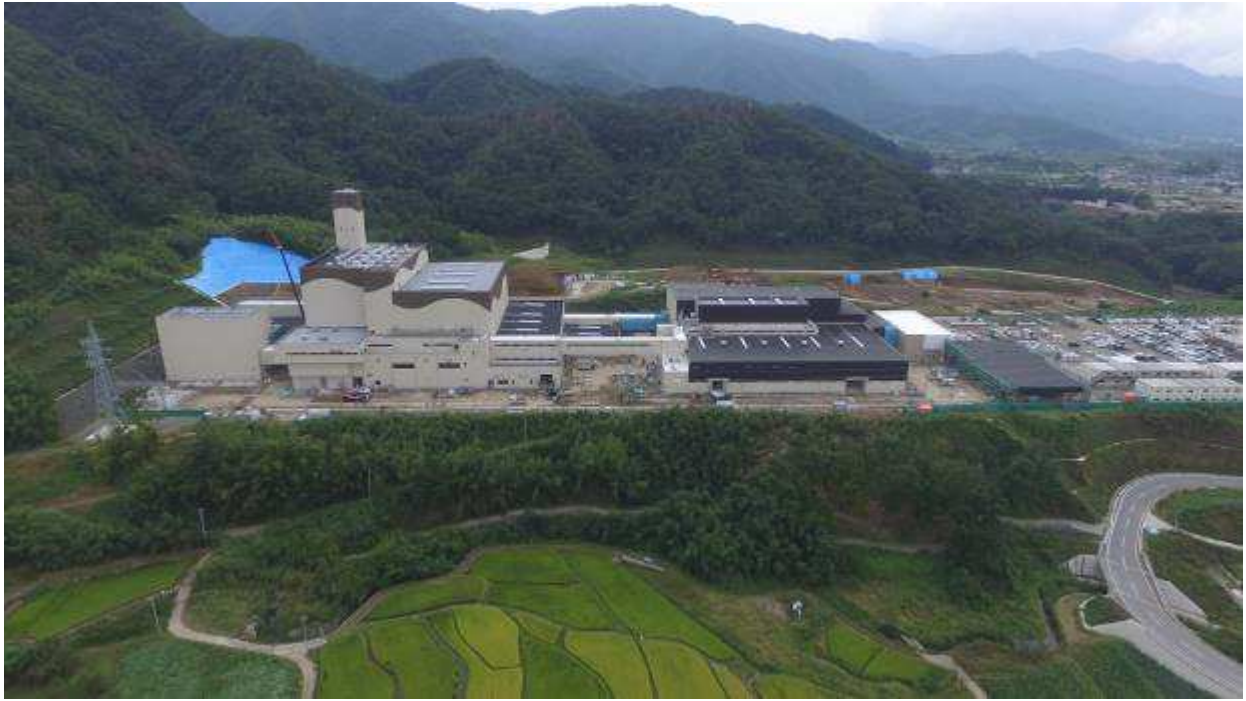
図 2-2-17(3) ごみ処理施設の工事実施状況（全体 北側視点） 平成 28 年 9 月時点
