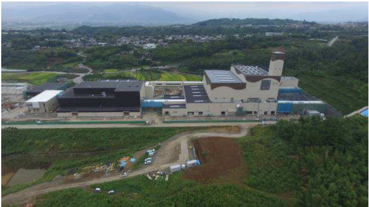
図 2-2-17(4) ごみ処理施設の工事実施状況（全体 南側視点） 平成 28 年 9 月時点
