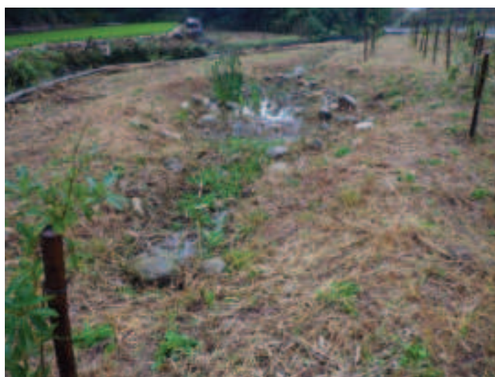
写真 5.10-6 土砂が流入した下流側ビオトープの状況（令和元年10月18日撮影）
