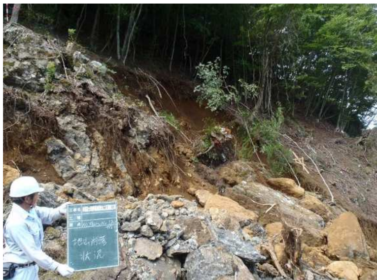
法面崩落の状況
