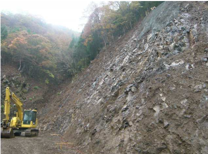
⑦ 切土法面岩盤の強風化状況
