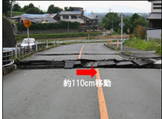
出典：熊本地震による被災及び復旧状況（国土交通省）
