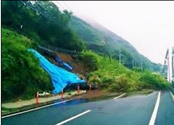
出典：熊本地震による被災及び復旧状況（国土交通省）
