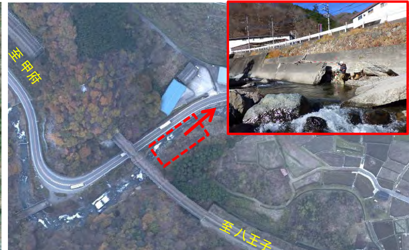
③【R6補正対策工事】山梨県大月市笹子町白野地先 【防災対策】河川護岸補修/コンクリート中詰め工
