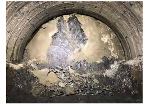
切羽崩落状況 写真：2024年8月 ※掘削進捗：約1,500m/約2,300m(2024.10)
