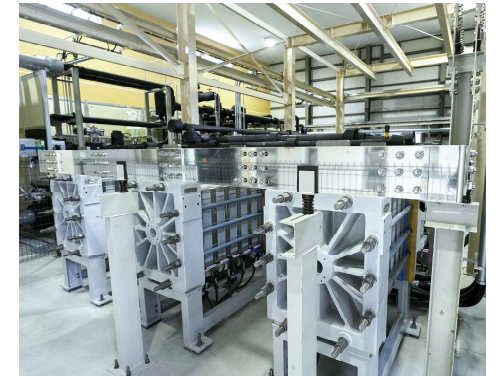
グリーン水素パーク - 白州 - に設置された施設(左)と内部の水素発生装置(右)
