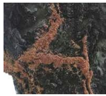
蟻道 (蟻が移動するトンネル)
