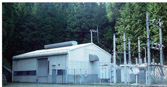
琴川第一発電所
