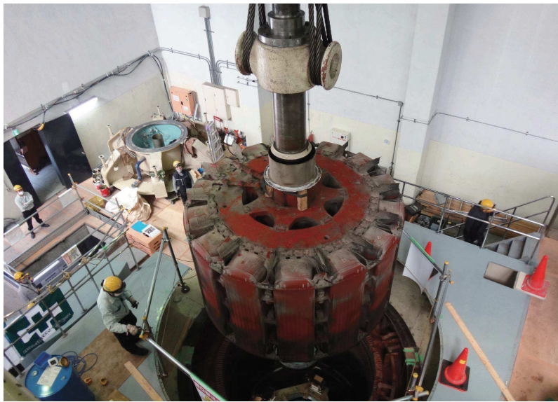
野呂川発電所水車発電機分解点検
