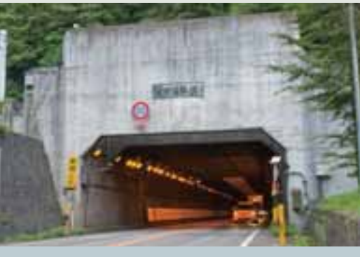
昭和42年、御坂有料トンネルが開通、旧道は主役の座を降りた。
