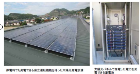
停電時でも発電できる自立運転機能を持った太陽光発電設備
