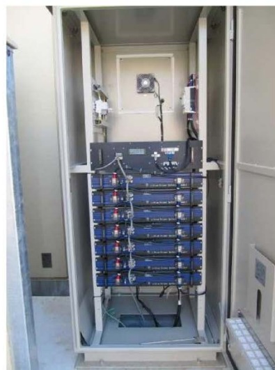
太陽光発電設備で発電した電力を受電できる蓄電池
