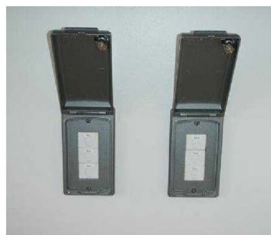
一般の電話回線が混雑しても優先的に使用できる特設公衆電話用ジャック
