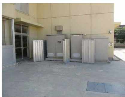
パワーコンディショナーと蓄電池盤
