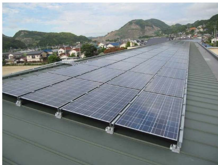
停電時でも発電できる自立運転機能を持った太陽光発電設備
