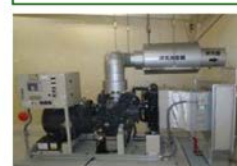
非常用発電設備
