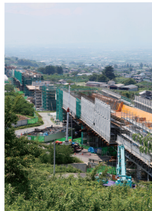
リニア実験線の延伸工事が進められています。 (写真は笛吹市御坂町)
