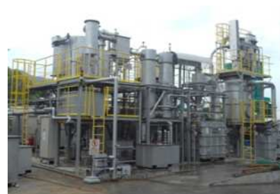
木質バイオマス発電所
