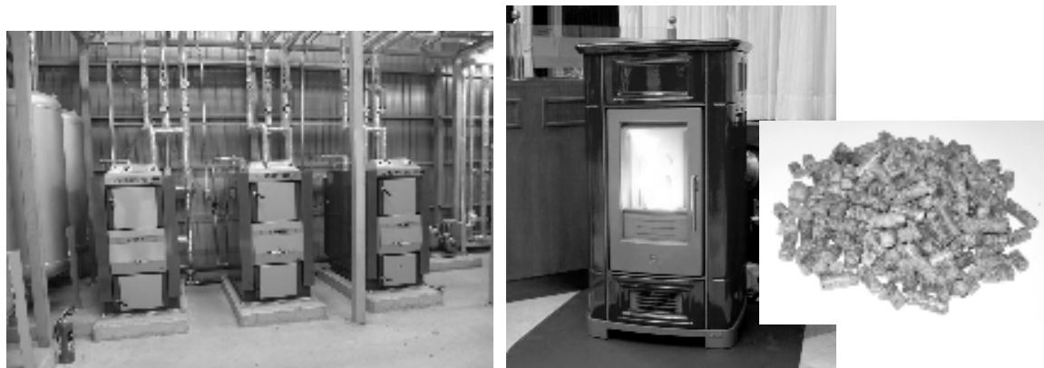
薪ボイラー(左)とペレットストーブ(右)
