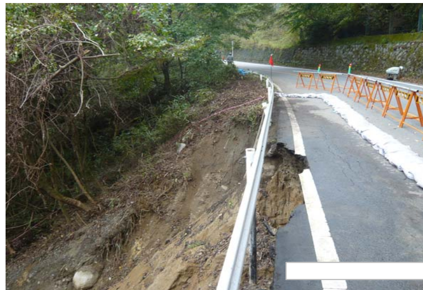
④終点部手前（H17.10月の台風による路側被災状況）
