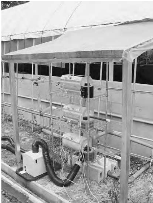
写真-13 堆肥舎に設置した三連のセラミック電気管状炉—金属酸化触媒式分解装置
