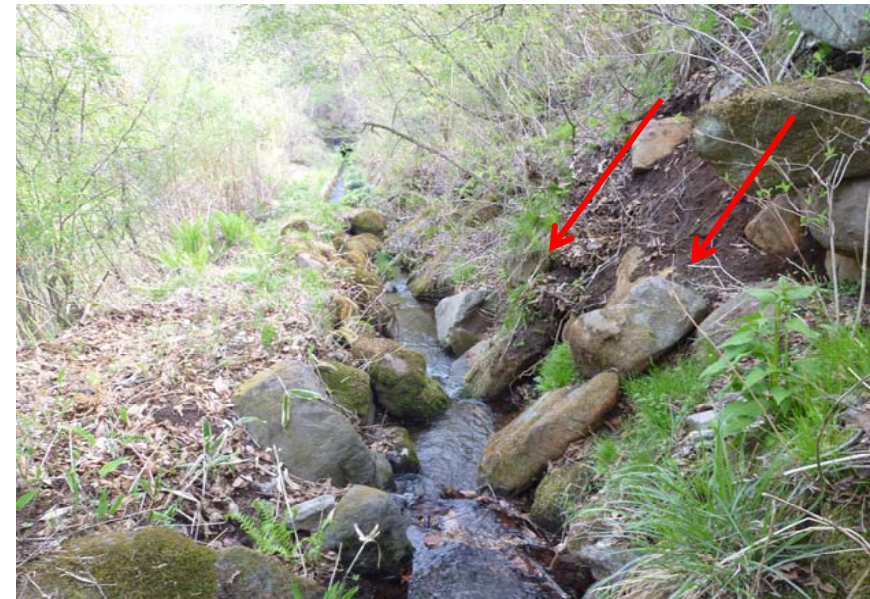
③水路は素堀の土側溝で、また落石により水流の妨げとなっている。
