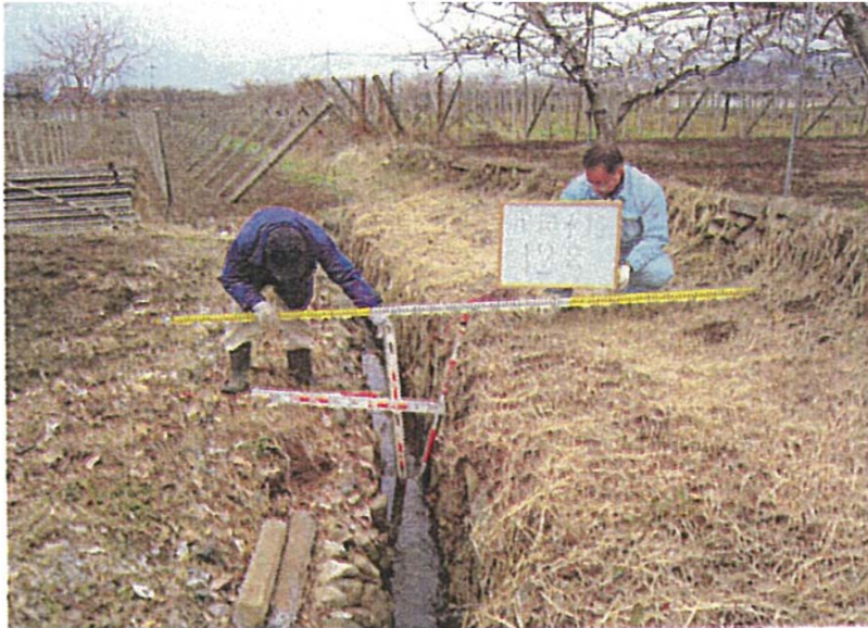
①着手前 土水路で漏水が多く、草刈り等の維持管理にも多大な労力を要していた。
