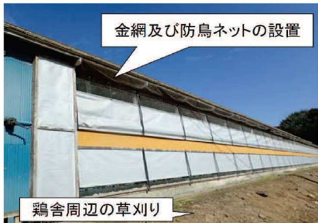
防鳥ネットの設置
