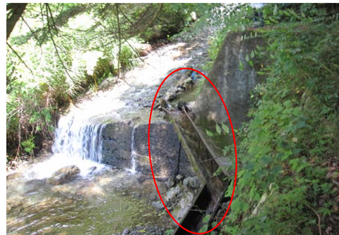
②取水部が未整備のため、用水供給が困難な農業用水路
