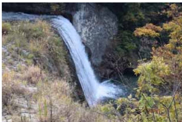
大正時代に完成した近代土木遺産 流れ落ちる滝は祇園の滝として親しまれている。 (甲州市 勝沼堰堤)
