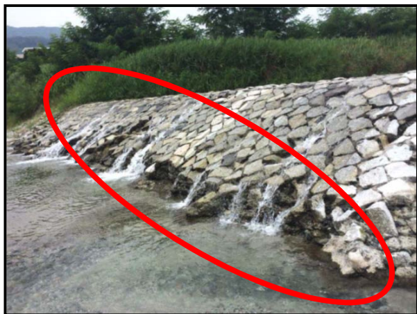
①堰体下部の損傷
