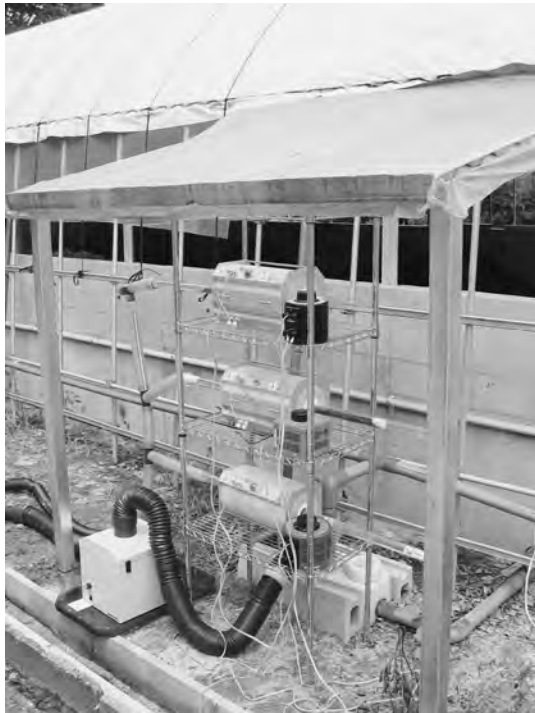
写真-13 堆肥舎に設置した三連のセラミック電気管状炉-金属酸化触媒式分解装置
