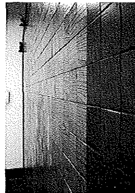
Fig. 9 現時点の壁面の全体の平滑性 (2005年撮影)
