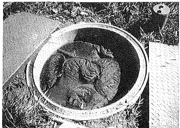
写真－4 同装置に汚水が流入している状況
