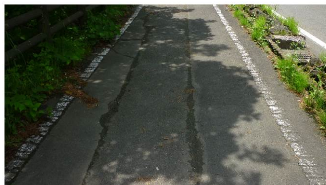
図- 4.13 老朽化による舗装損傷
