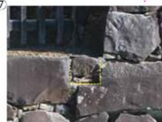
欠込と柱筋がずれている
