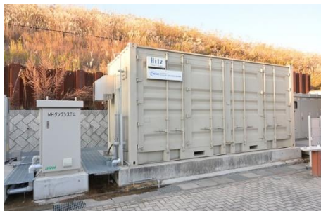
実証試験で水素を製造している水電解装置
