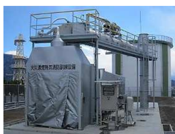
火災濃煙熱気消防訓練設備
