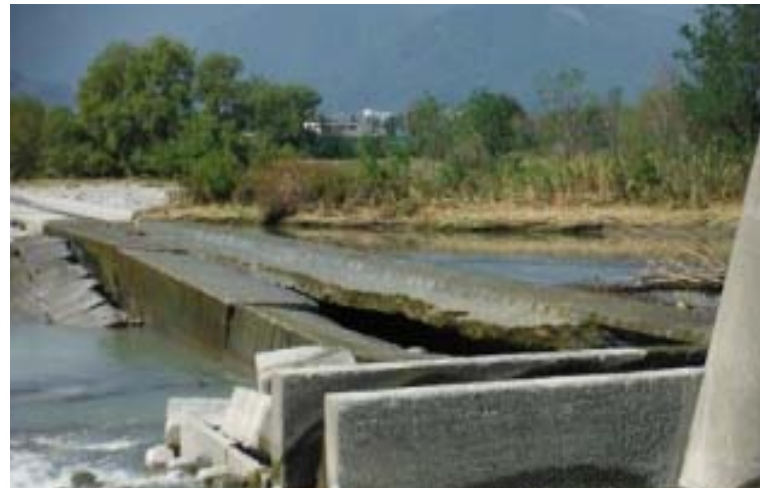
②豪雨(H25台風18号及び27号)時の水流により、固定堰の一部が破損した。(現在は仮復旧済)
