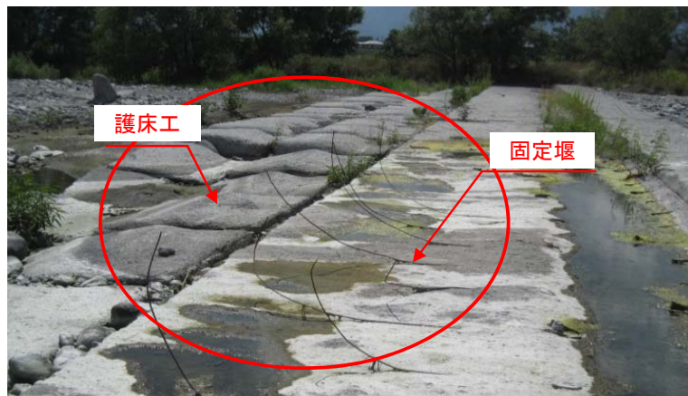
④豪雨時の水流等により堰の表面部が摩耗し鉄筋が露出しており、護床工は大きく削られ変形している。
