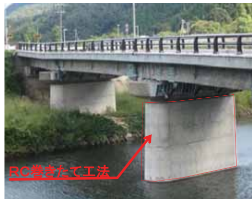
④既設コンクリートの周囲に 鉄筋コンクリートを増打ちする
