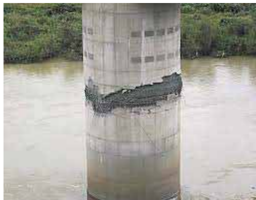
③強度不足による 橋脚の損傷状況(他地区)
